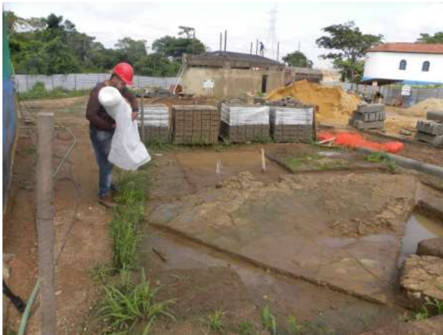
Figura 8– Piso com acúmulo de água da chuva em 2012. Foto: Ney Gomes.
